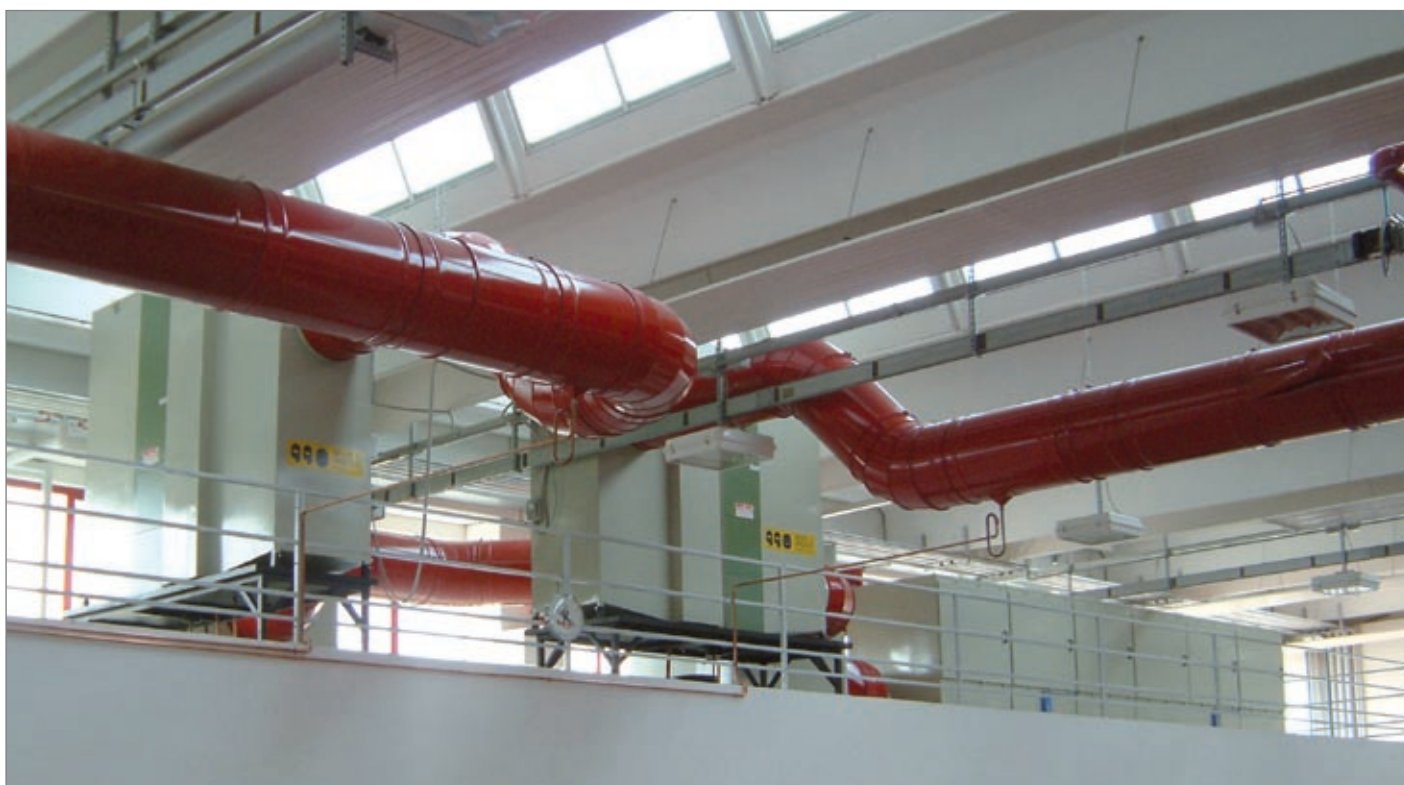
Installation de batteries filtrantes électrostatiques
