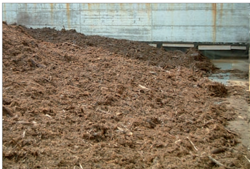
Biofiltre en phase de remplissage
