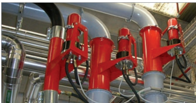
Compartimentage des tuyauteries
