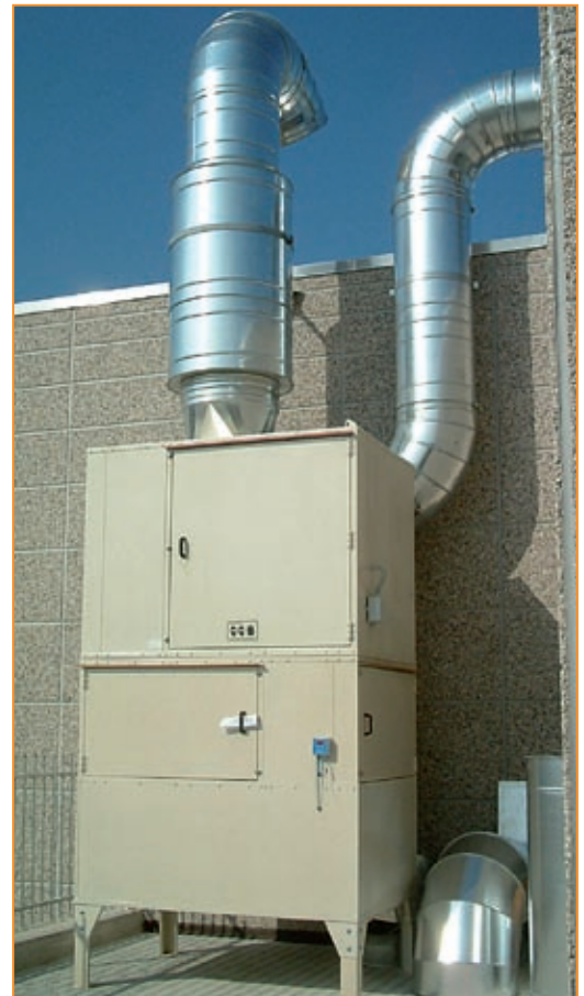
Insonorisation ventilateur et silencieux sur la cheminée d'évacuation
