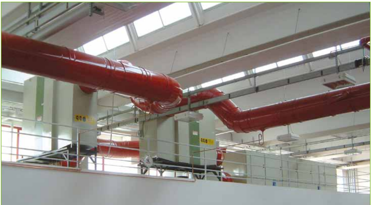
Installazione di batterie filtranti elettrostatiche
