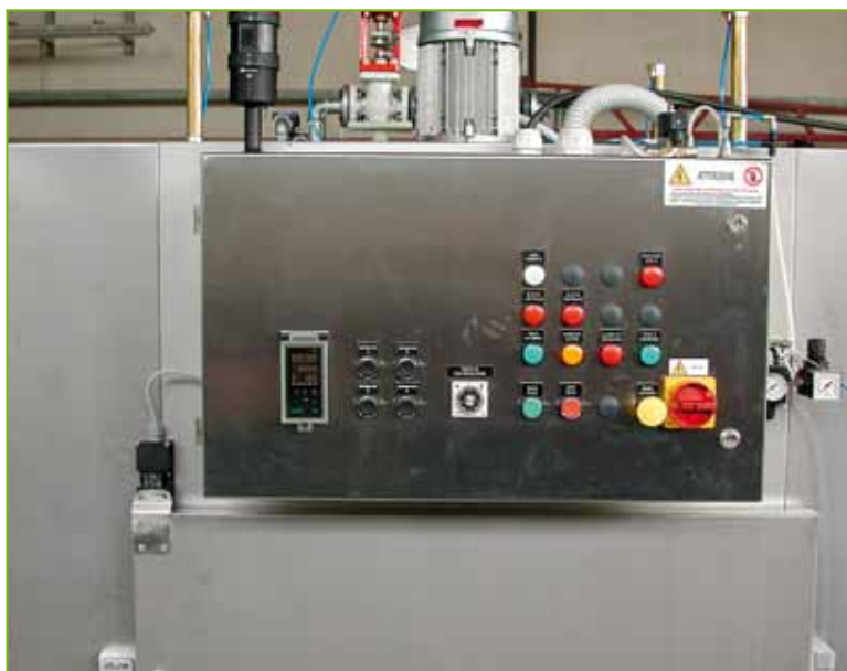
Il quadro elettrico installato sui FOREN
