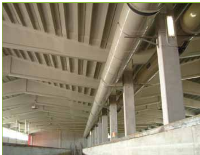
Tubazioni in polipropilene
