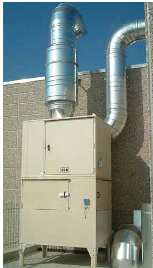
Insonorizzazione ventilatore e silenziatore sul camino di scarico
