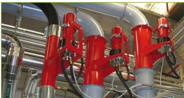
Compartimentazione delle tubazioni
