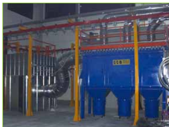
Depolverazione a cartucce su un impianto di verniciatura a polvere
