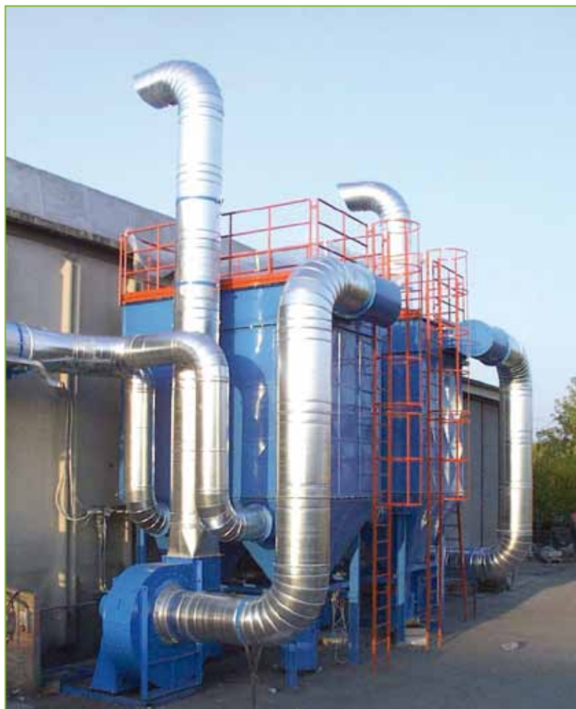
Impianto di filtrazione su impianto di verniciatura a polvere
