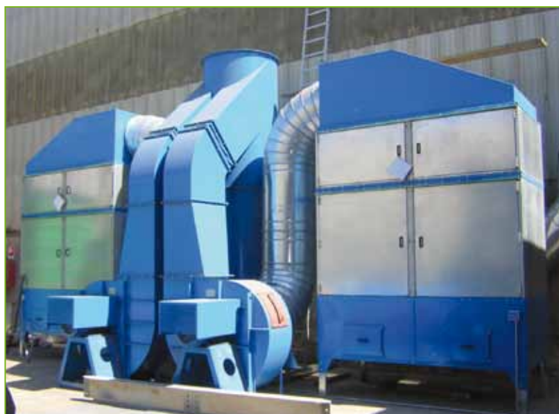
Impianto di aspirazione per cabina di verniciatura torri eoliche
